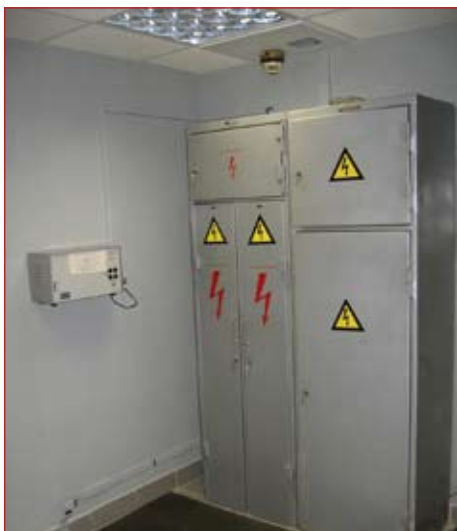
Звуковая трансформаторная подстанция (ЗТП)
