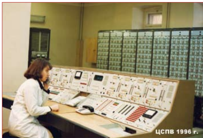
Пульт диспетчера Центральной станции проводного вещания МГРС
